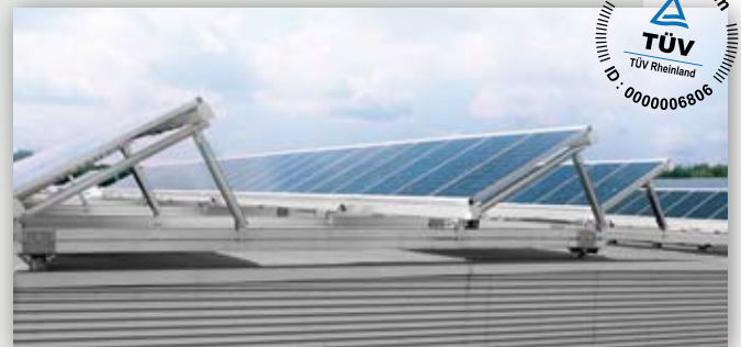
Industriehallendach mit 35 kWp Anlage
