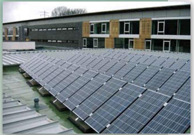
Universität in Meschede 7,76 kWp
