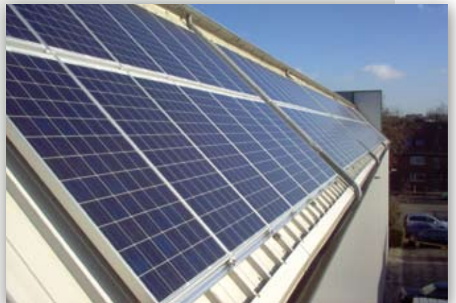
Industriehalle in Oberhausen 41,14 kWp
